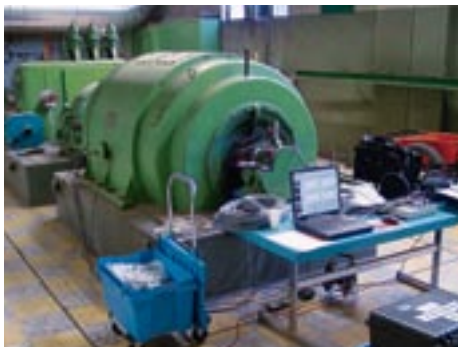
Schwingungsanalyse an einem Turbogenerator
